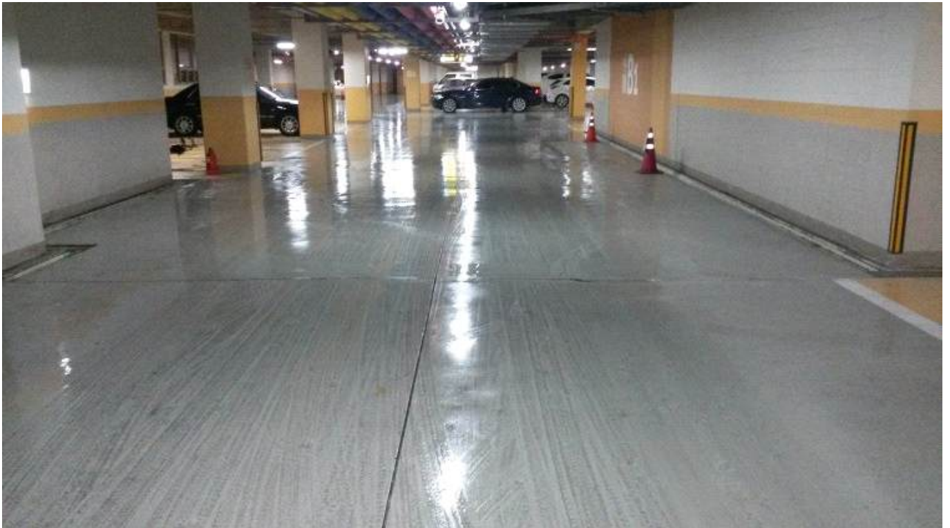
◆지하 주차장 바닥 결로 현상◆
