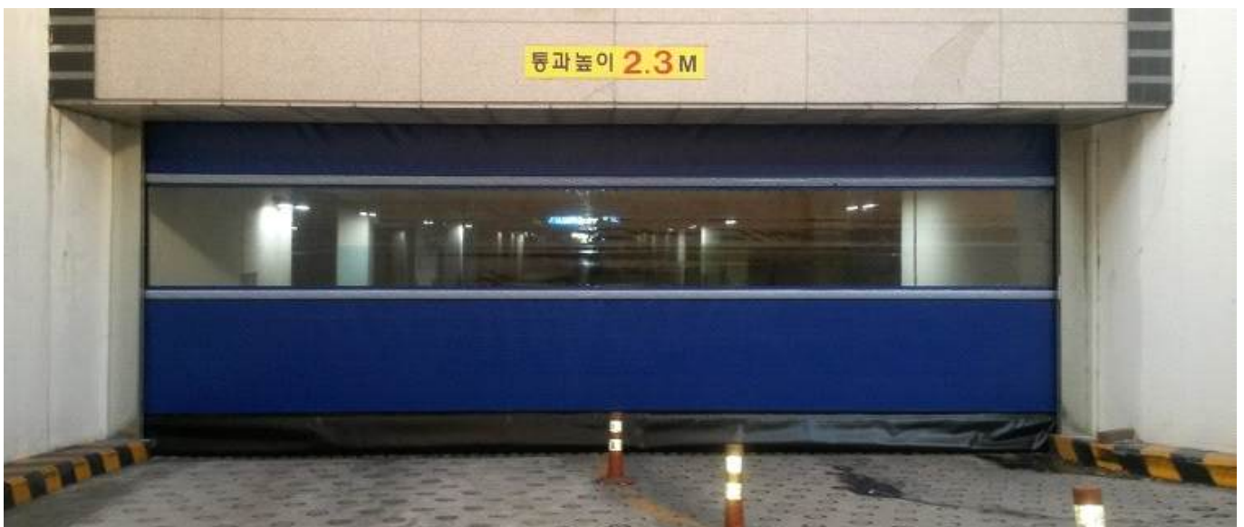
◆아파트 지하 주차장 차량 출입 램프에 설치된 스피드 도어 ◆
