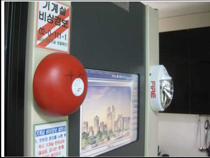
관리사무소 출력 설비(강력벨, 시각경보기)
